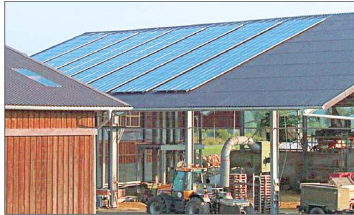
Solarmodule auf dem Eichhändlerhof in Königsbach-Stein sorgen für eine umweltfreundliche Energiebilanz.
